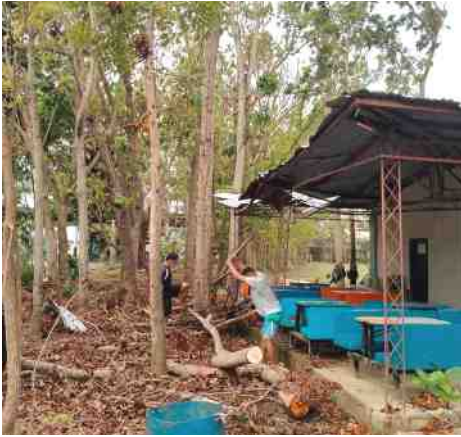
Aufräumarbeiten in Liloan
